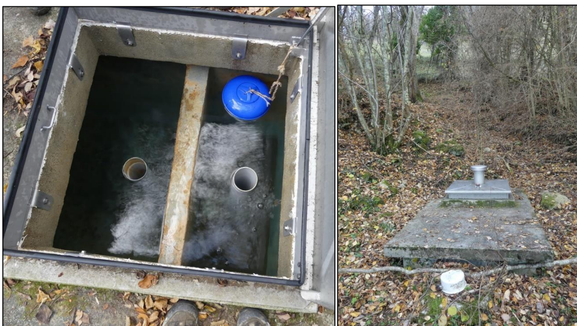
Figure 3 : Photographies du captage la Calmette
